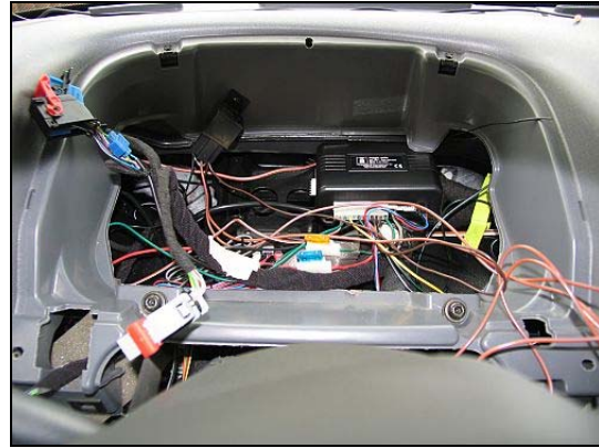
Abbildung 4: Steuermodul unter der Armaturentafel
